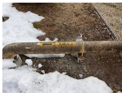
ボイラーとパイプライン
